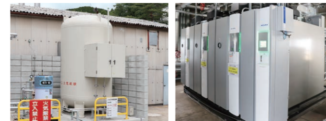
LPG供給設備
