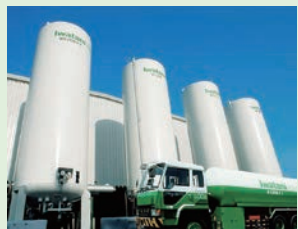
高圧ガス供給設備
