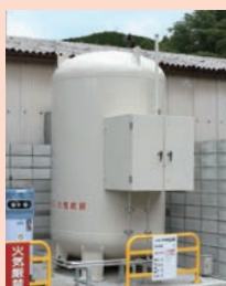
LPガス供給設備
