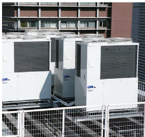
GHP(ガスヒートポンプエアコン)
