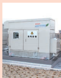
LPガス非常用発電機
