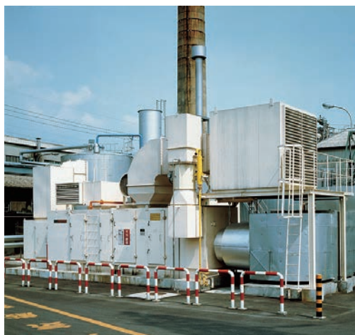
コージェネレーションシステム
