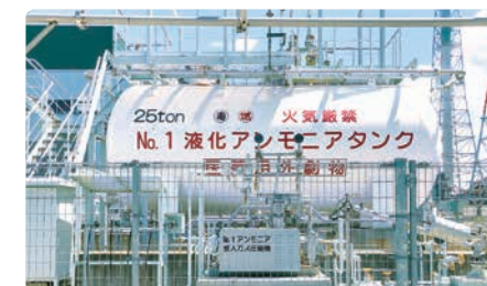
アンモニア供給設備
